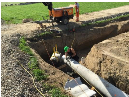
Stahlleitung ST 400 FZM kat
