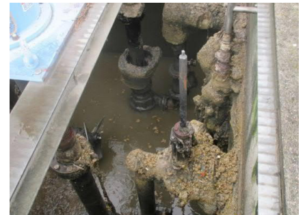
Fettablagerungen im Pumpensumpf
