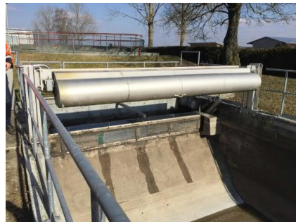
Regenbecken mit Sieb und Spülkippe
