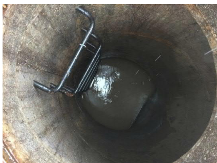
Zulaufkanal DN 1'000 zum Abwasser-Pumpwerk
