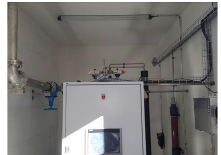
Technikraum beim Reservoir Tatz
