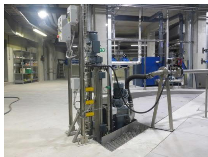
Schwimmstoffabzug aus Fettfängen
