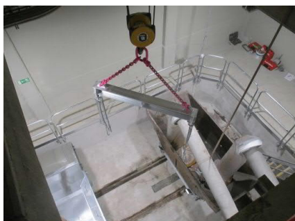
Abwasserrechen mit Rechengutwaschpressen und Rechengutmulden
