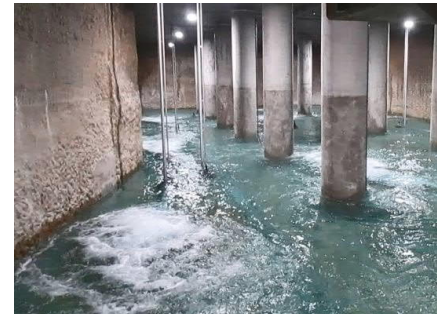
Airjets nach Inbetriebnahme mit sauberem Wasser
