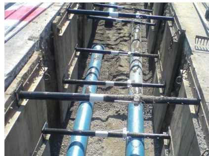
Duktile Guss-Leitungen, eingebettet in Betonkies
