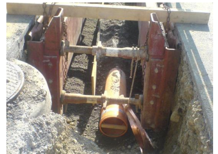
Schmutzabwasserleitung, eingebettet in Sohlen- und Hüllbeton
