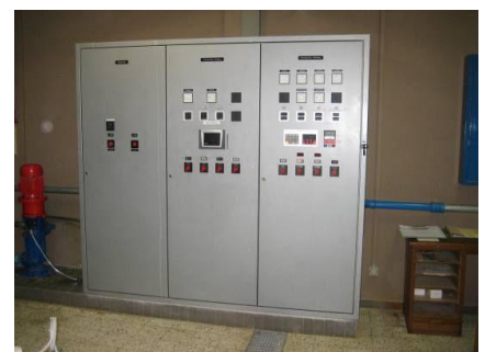
Steuerung im bestehenden Schrank integriert
