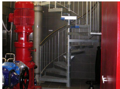
Pumpe mit Spindeltreppe
