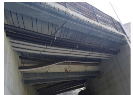
Isolierte Leitung am Brückenkörper aufgehängt
