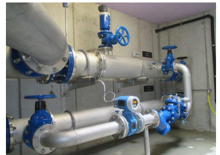
Verbindungsschacht mit Druckhaltung und Be-/Entlüftungsventil
