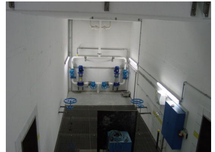
Rohrkeller mit Bedienelementen
