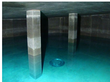
Gefüllter Reservoirbehälter mit der Entnahmeturbine in der Mitte
