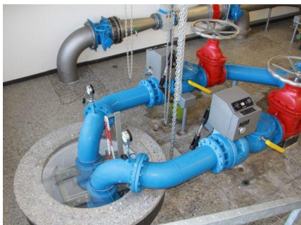
GWPW vor Umbau, Versorgung nur obere Zone
