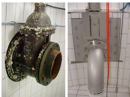
alter / neuer Schieber mit Pneumatikzylinder und Einlaufbogen
