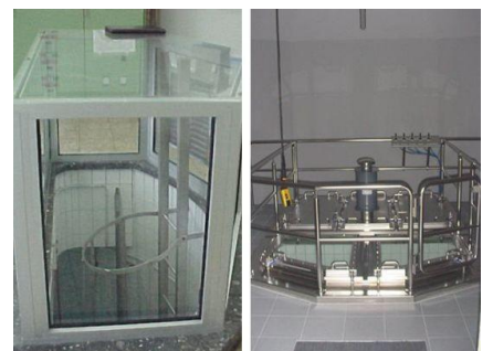
alter Schachteinstieg / neue Chromstahlabdeckung mit Luftfilter
