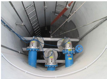
Im Grundwasserbrunnen sind alle Installationen überflutbar konzipiert. Die Ansteuerungen sind im Verteilpumpwerk untergebracht.
