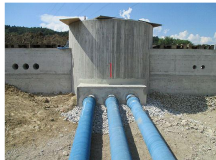
Für jede Pumpe führt ein separates Rohr vom Brunnenkopf zum Verteilpumpwerk
