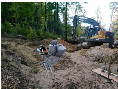
Brunnstube mit Kontrollschacht
