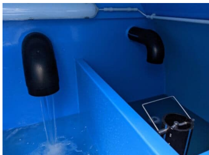
Unterirdische Sammelbrunnstube aus Kunststoff
