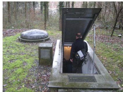
Eingang zu Unterflur-Grundwasserpumpwerk
