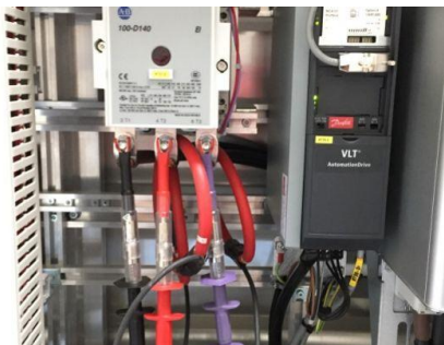
Installierte Kurzzeitmessung (eine Woche) im Schaltschrank
