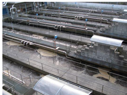
Belebtschlammbecken, welche teilweise ausser Betrieb genommen wurden
