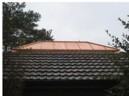
Demontierbarer Dachaufsatz zum Ein-/Ausbringen von Pumpen und Motoren
