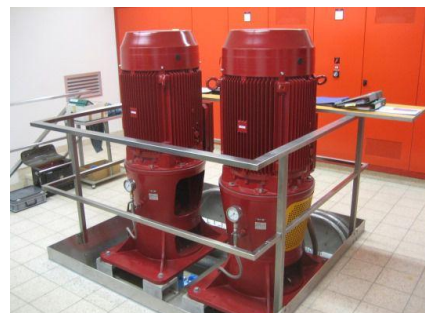
Hocheffiziente 132 kW IE3-Antriebe der beiden neuen Bohrlochpumpen
