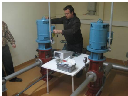
Pumpenmessung vor Ort durch den Lieferanten
