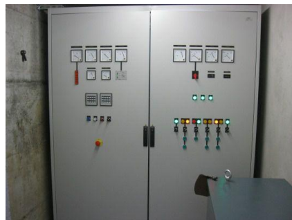
Steuerschrank und Trafo
