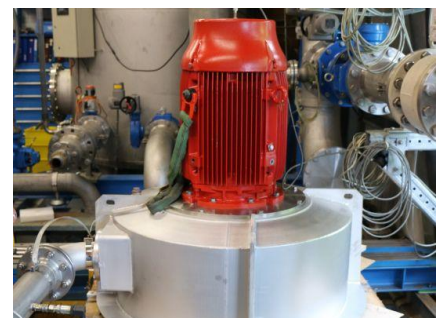
Turbine auf Prüfstand bei Trockenabnahme
