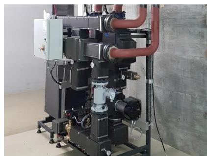
Die neue Fernwärmeübergabestation versorgt die ARA mit Wärme
