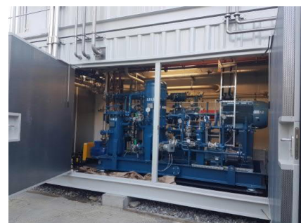
Hauptverdichter mit 130 kW Antriebsmotor und Frequenzumformer
