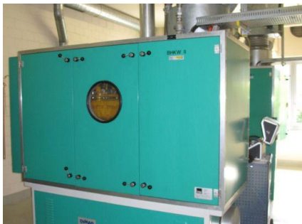
Bisher verwendete Dimag-BHKW mit 45 kW elektrischer Leistung
