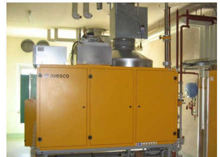
Neues Avesco-BHKW mit Schalldämmhaube während der Einbauphase
