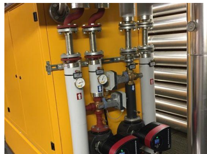
Die neu installierten Umwälzpumpen für den Heiz- und Notkühlkreis sind mit Frequenzumformern ausgerüstet
