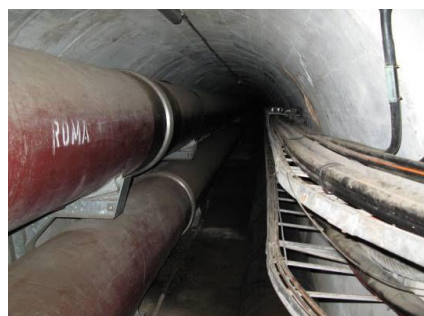
Bestehender Leitungsstollen zwischen Lugano und der ARA, welcher auch für die Fernwärmeleitungen genutzt werden kann
