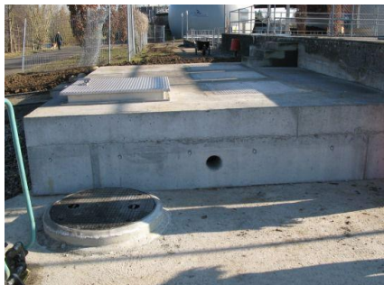
Abwasserentnahmebauwerk mit Montageöffnungen für Pumpen Einstiegsschacht
