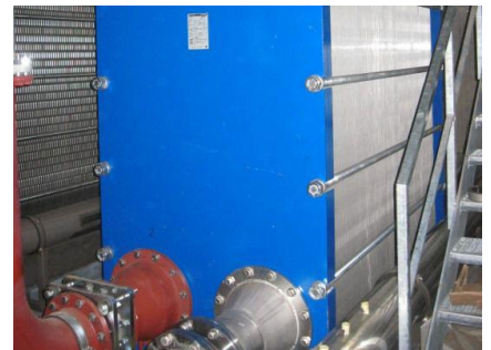
Freistrom-Plattenwärmetauscher für Wärmeentnahme aus dem gereinigten Abwasser
