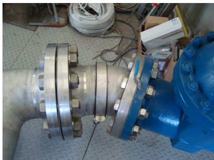
Grossrohrinstallationen in PN 63
