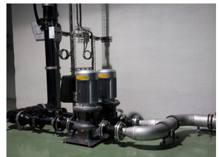
Die Abwasserpumpen fördern das gereinigte Abwasser zu den Wärmeübertragern
