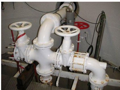
alte Förderleitung im Filterbrunnen
