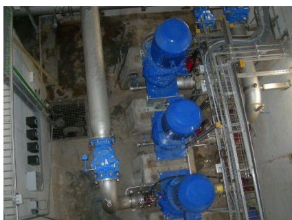
Pumpenraum nach der Installation der neuen Pumpen
