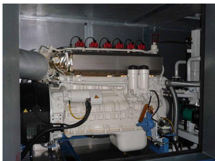
Motorblock des neuen BHKW
