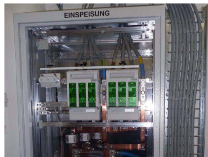
Einspeisung des netto produzierten Stromes ins Netz der ESAG mittels neu erstellter Einspeisung
