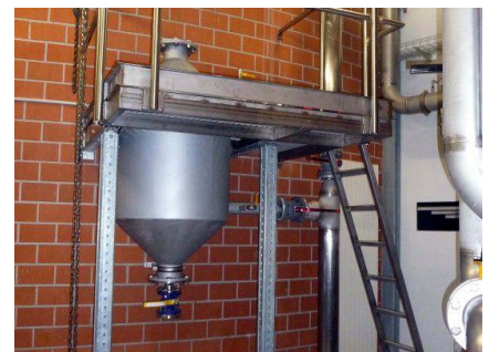
Der Aktivkohlefilter mit Podest zur Befüllung
