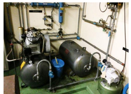
Druckluftanlage mit Kompressor und Druckluftbehältern
