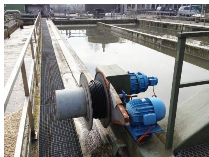
Antriebseinheit Vorklärbeckenräumer mit Stromzuführung mittels Kabelrolle
