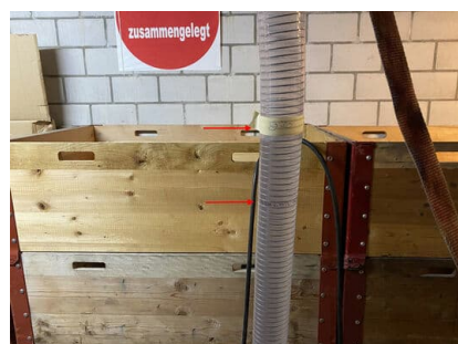
Wassersäule mit Sanierungskomponente mind. 2 m. Pfeil oben: Ausgangspunkt Rohrbefüllung, Pfeil unten: aktueller Stand Rohrbefüllung, Differenz = Verlust durch Undichtigkeiten
