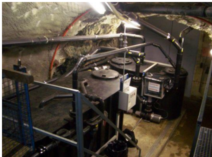
Fettabscheider (vorne) und Pumpensumpf im Raum der ehemaligen Vorklärung der KLARA Mittelallalin
