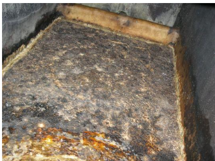
Fettabscheider Korridor vor Leerung und Reinigung
