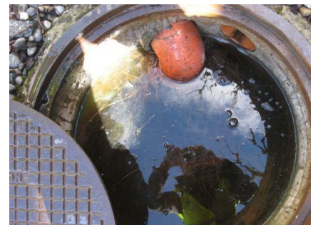
Schachtbauwerke z.T. mit Wurzeleinwuchs
