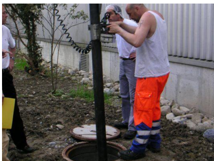
Entleerung erdverlegter Fettabscheider
